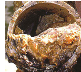
Tuberías de alcantarillado y tuberías privadas obstruidas debido a la grasa
